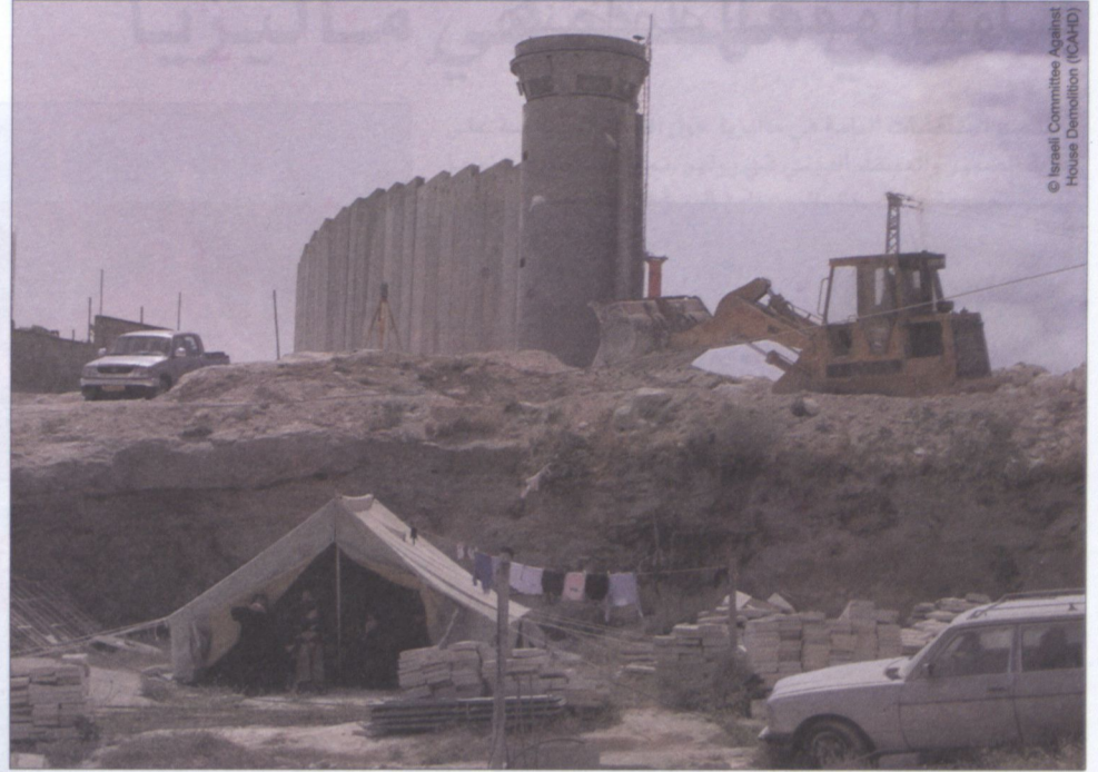
عائلة الزعارة تعيش الآن في خيمة نصبوها على انقاض منزلهم الذي دمته السلطات الإسرائيلية في أبريل/نيسان 2004. توطئة لبناء السور/الجدار، الذي يظهر أيضاً في الصورة، في ضاحية العزارية بالقدس الشرقية.
