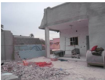
La maison endommagée de la famille Awana à Garara.
