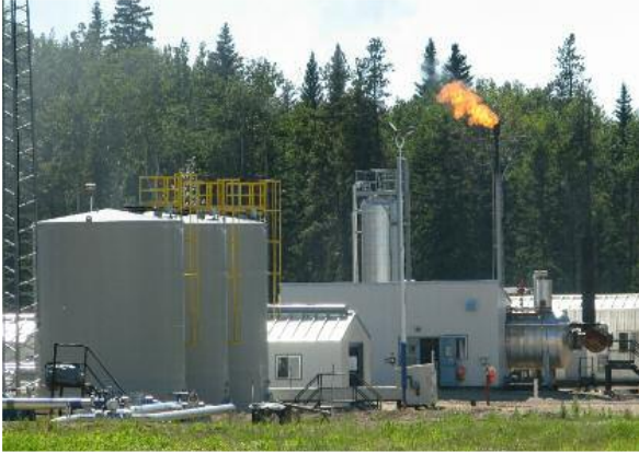
Installations pétrolières et gazières sur les terres des Cris du lac Lubicon. © Amnesty International
