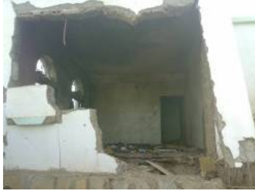
مبنى مدمر في أبيين © Private
