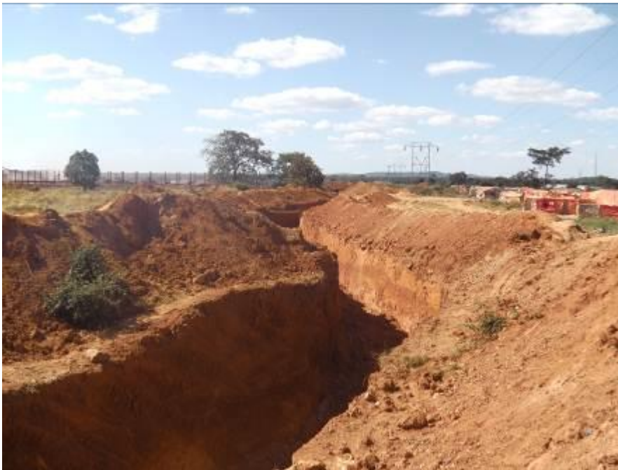
La tranchée creusée à Luisha par la Compagnie Minière de Luisha (COMILU), 20 avril 2012.
