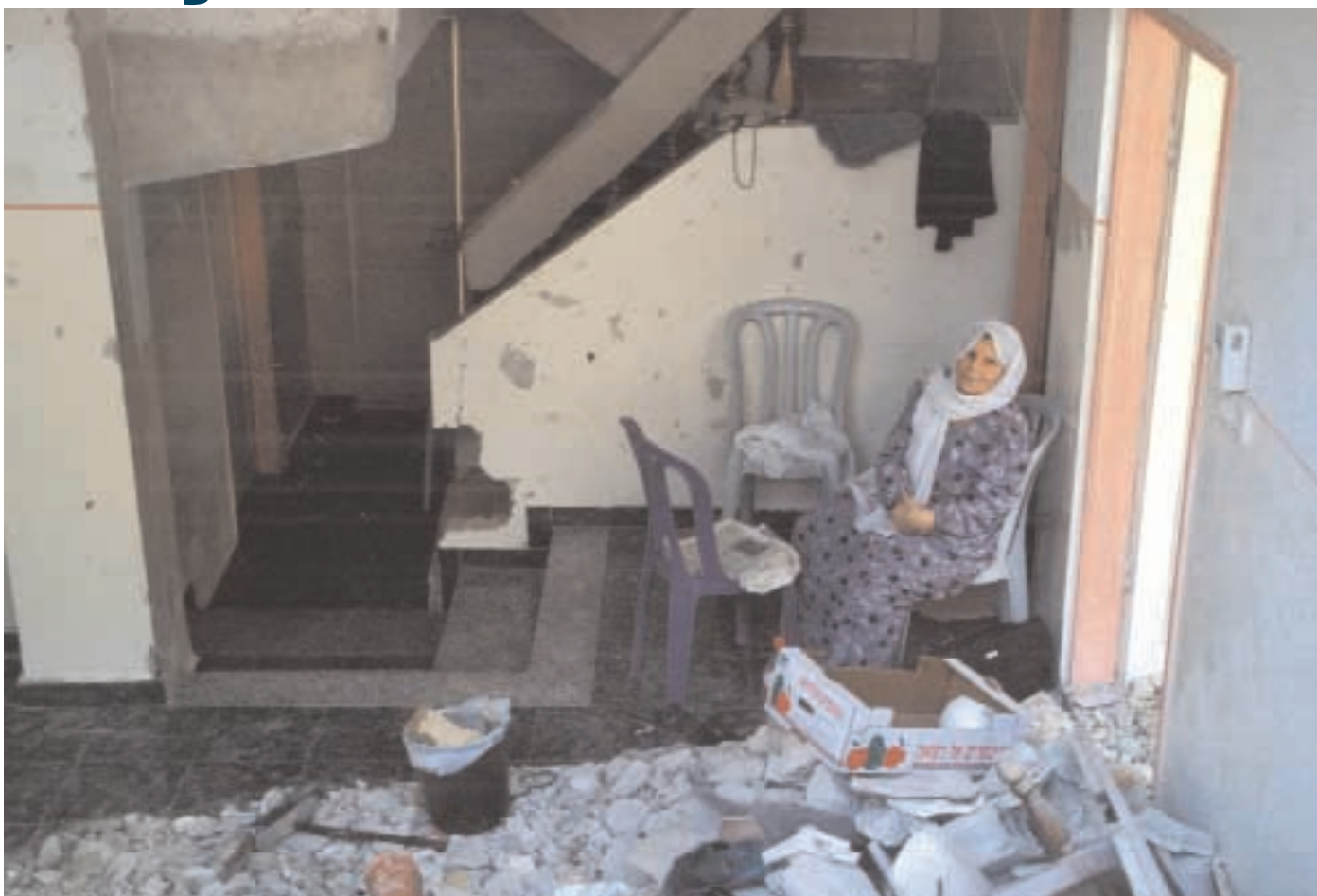
Mujer sentada entre los restos de su hogar, en el campo de refugiados de Al 'Ayn, en Naplusa. La casa sufrió daños irreparables al destruir el ejército el edificio contiguo en octubre de 2002 como medida punitiva. © Amnistía Internacional
