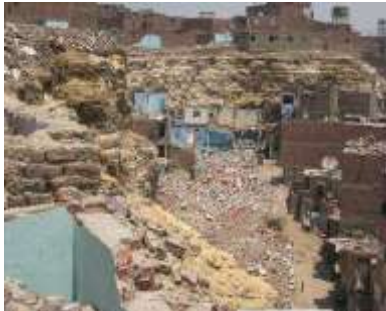
Flanc de colline à Establ Antar (5 août 2009). Des habitations détruites par les autorités, il ne reste que des décombres. Les habitants restés sur place craignent à tout instant que le prochain logement à être démoli soit le leur. © Amnesty International
