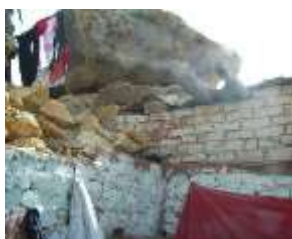
Vue de chez Shirihan Hamdi Mohamed Ahmed, dans le secteur de Shohba, à Duwayqa (9 février 2009). Elle a raconté aux délégués d'Amnesty International que le toit en bois s'était effondré après la chute d'un bloc de pierre.
