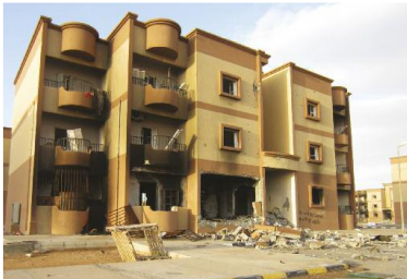
Des immeubles vides et détruits à Tawargha. © Amnesty International
