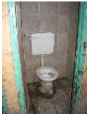
Des toilettes communales sans porte dans le camp de Nomentano, Rome, mars 2012. © Amnesty International
