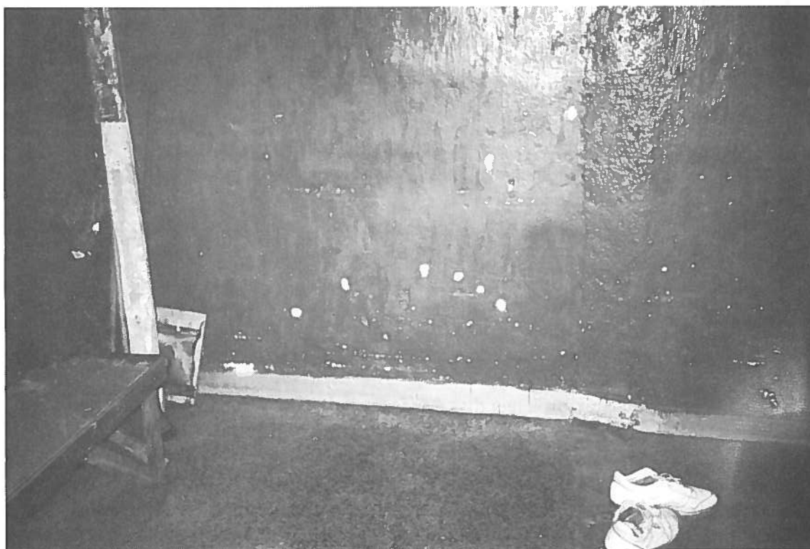
Marcas de rajada de metralhadora cerca do nível do chão na cela 339 E. Seis presos foram mortos nesta cela. c. AI.
