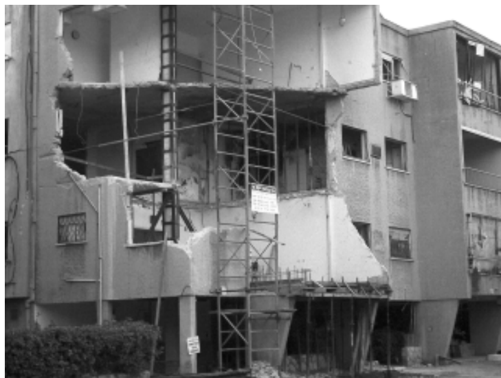
Многоквартирный жилой дом в Хайфе (Израиль), разрушенный выпущенной «Хезболлой» ракетой в ходе конфликта с 12 июля по 14 августа 2006 года. © МА
